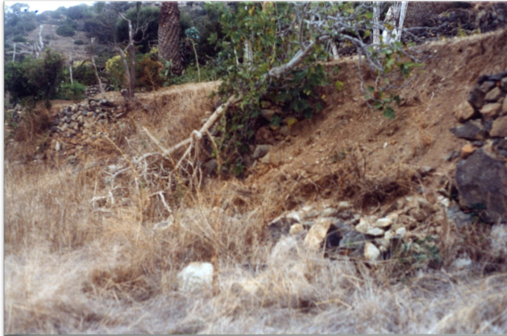
Figura VI.5. Especies arbustivas y arbóreas desestabilizando muros de bancales.
