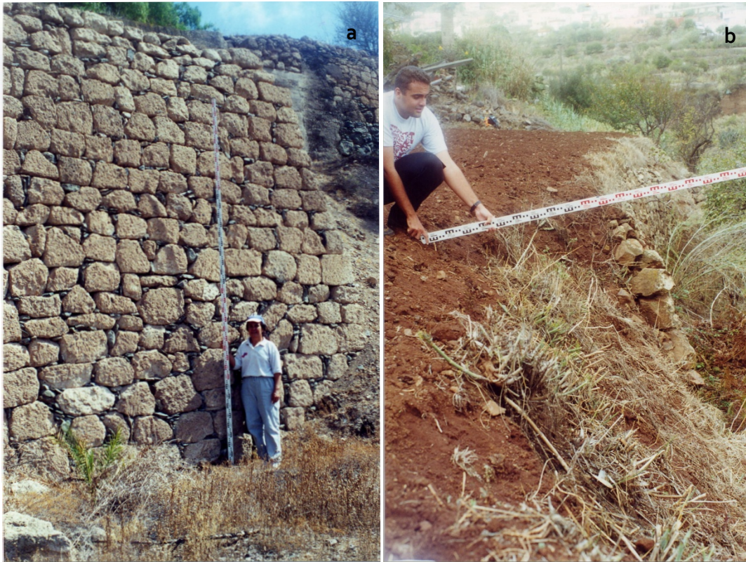
Figuras II. 18 a y b. Medida de las dimensiones y de los procesos de erosión existentes en los muros de los bancales.
