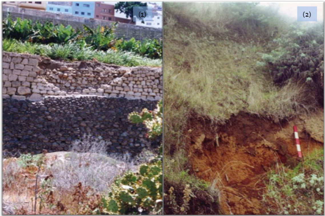
Figura V.11. (1) Caída de piedras en bancal de mampostería compuesta (sillería de ignimbritas y cantos rodados en la base) San Roque, y (2) caída de tepés en Las Lagunetas.
