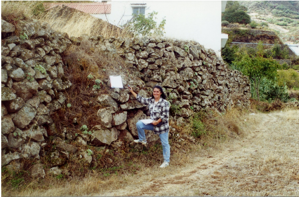
Figura VI.19. Abombamiento de muro de bancal con rellano horizontal. Las Lagunetas.
