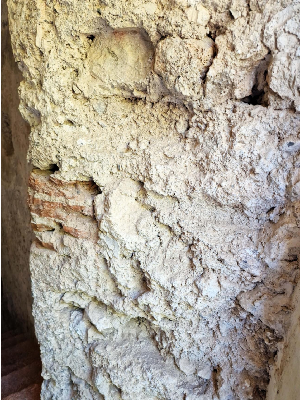
Fotografía 7.73: ladrillos rojos de arcilla (centro izquierda de la imagen), entre mamposería, del Aljibe Califal (siglo X), en la Alcazaba de Almería, revestidos con forros de mezclas peculiares de cal, arena de río y tierra (en ocasiones) ¿en posteriores restauraciones? Captura del 20 de agosto de 2023.
