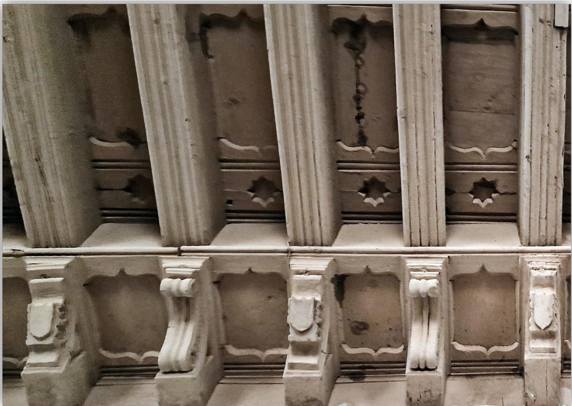
Fotografías 7.58 y 7.59: techo plano lignario ataujerados de 1537 (Barrado Barquilla, 2018), con las jácenas apoyadas en canecillos. Taller de Carpintería. Escuela de Arte y Superior de Diseño de Almería (antiguo Convento de Santo Domingo el Real, construido entre los siglos XVI-XVIII). Capturas del 1 y 4 de diciembre de 2023.
