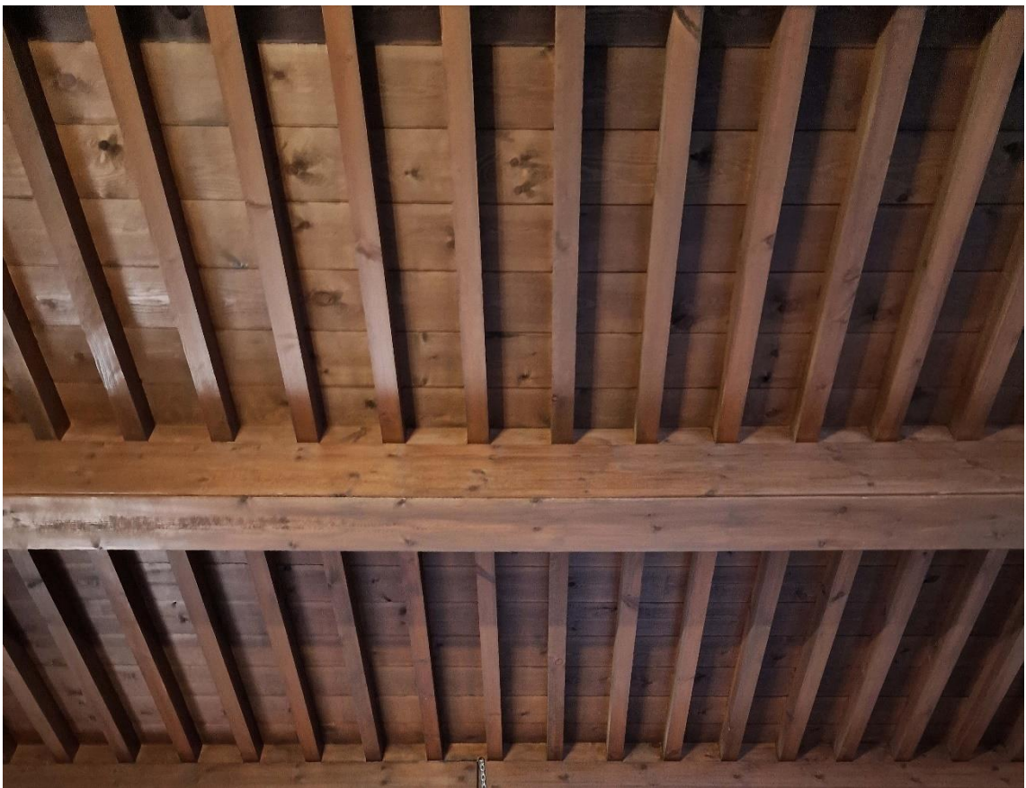
Fotografías 7.56 y 7.57: techo plano lignario de alfarjes, con jácenas, jaldetas y tablazones. Las jácenas lignarias se encuentran apoyadas en canecillos de madera. Sala Capitular del Convento de Las Puras (Almería). Capturas del 27 de noviembre de 2023.
