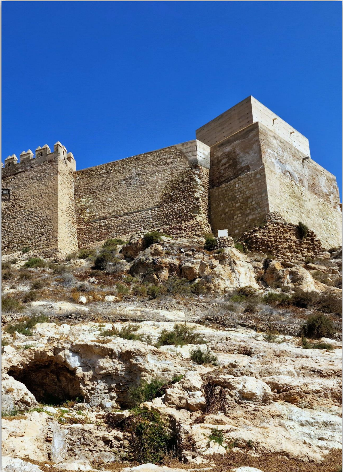
Fotografía 5.6: detalles de la fachada externa suroriental de la Alcazaba. La erosión permite observar que las murallas, de este sector de la fortificación musulmana, fueron construidas en mampostería, con el empleo de piedras y sillares. Captura del 18 de agosto de 2023.
