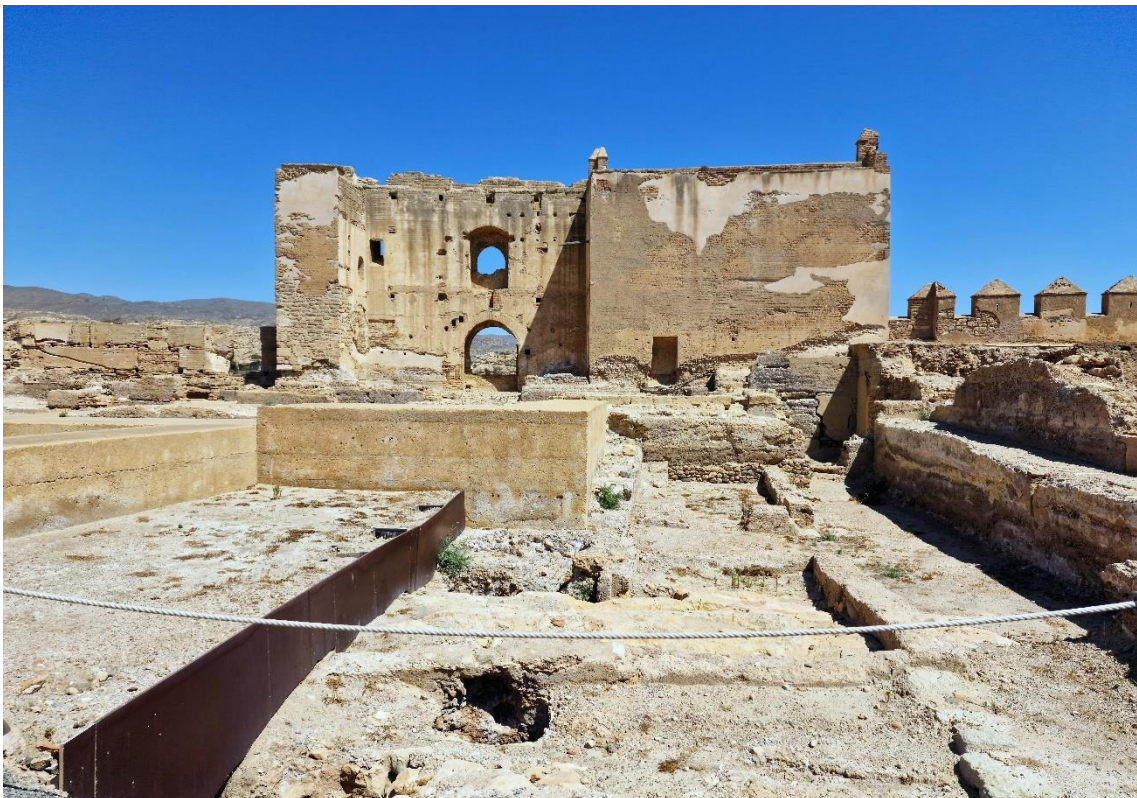
Fotografía 5.5: fachada de la Torre de la Odalisca, en el segundo recinto actual de la Alcazaba. La Odalisca. Captura del 23 de agosto de 2023.
