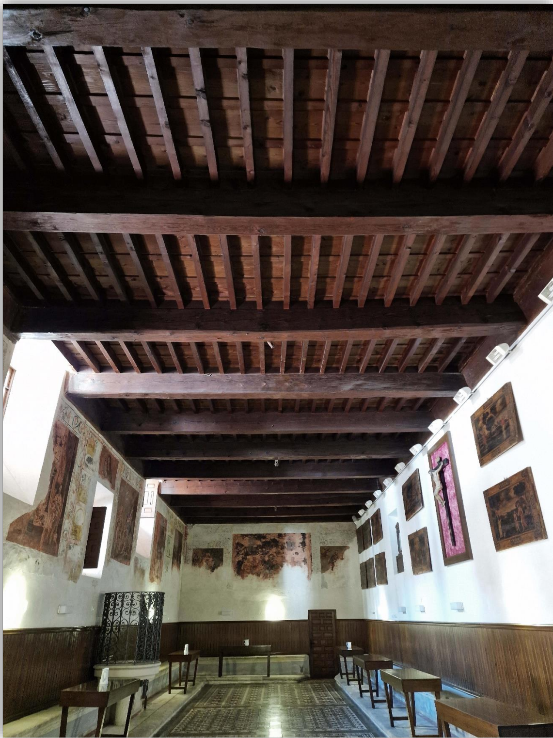
Fotografía 7.55: techo plano lignario de alfarjes, con jácenas, jaldetas y tablazones. Refectorio del Convento de Las Puras (Almería). Captura del 27 de noviembre de 2023.
