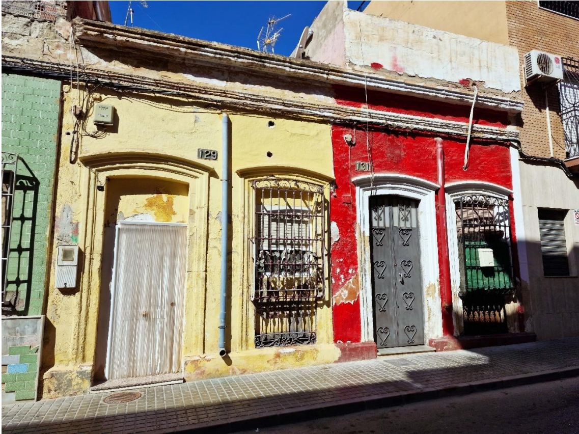
Fotografía 8.9: casas de puerta y ventana , con falta de mantenimiento, y con coloraciones poco habituales. Calle Gran Capitán, números 129 y 131. Captura del 1 de agosto de 2023.
