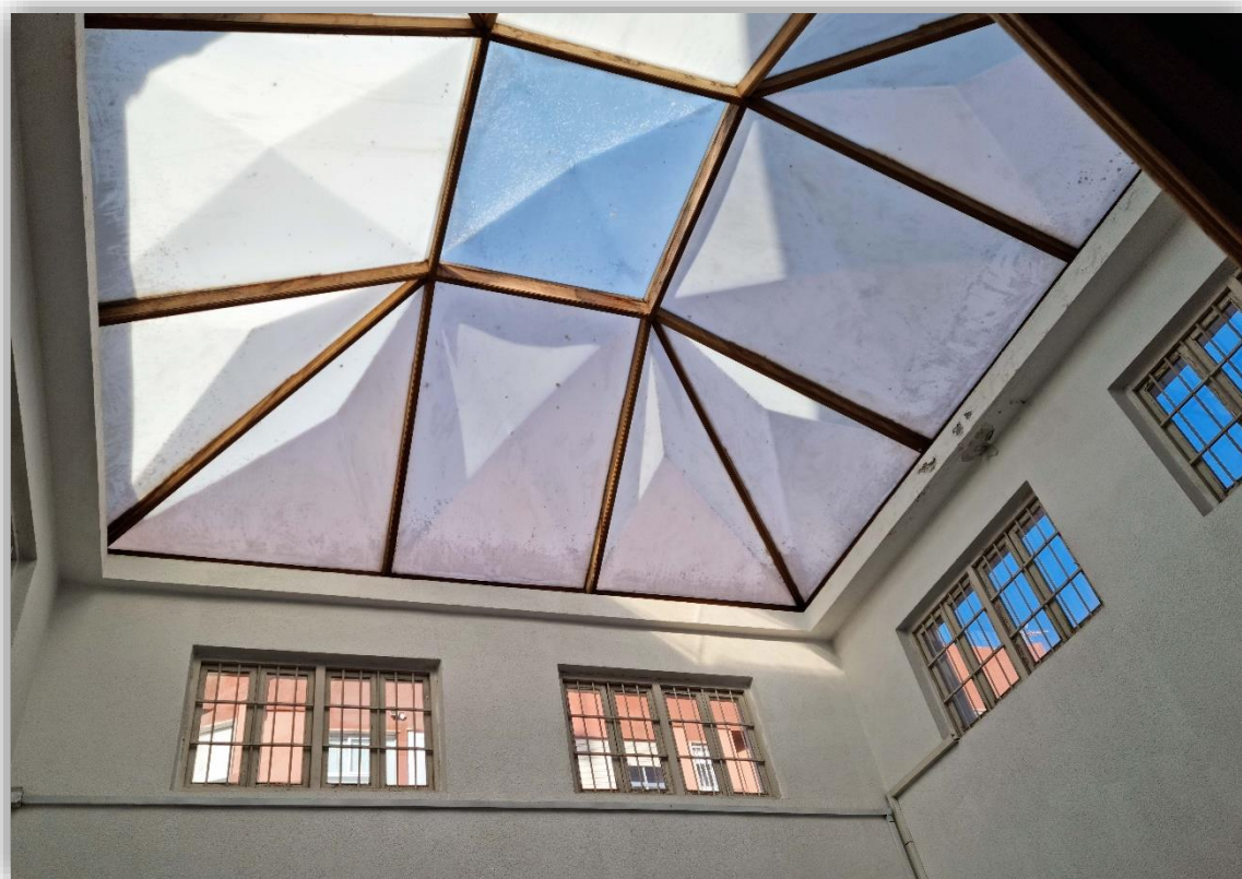
Fotografía 8.130: vista parcial de la claraboya, que corona la tercera altura, del edificio de don Fernando Roda. Captura del 30 de noviembre de 2022.
