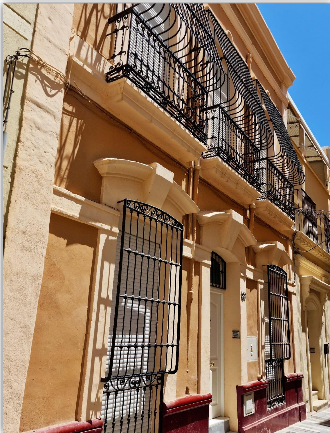
Fotografía 8.55: fachada con aires del estilo externo popular del Mediterráneo más occidental, en una casa con tipología edificatoria externa ecléctica. La edificación tiene, como anomalías constructivas más sobresalientes, una segunda altura y balcones con rejas de un cuerpo, en su modalidad de buche de paloma ( pecho palomo ). Calle Pueblo, nº 28. Captura del 21 de agosto de 2023.
