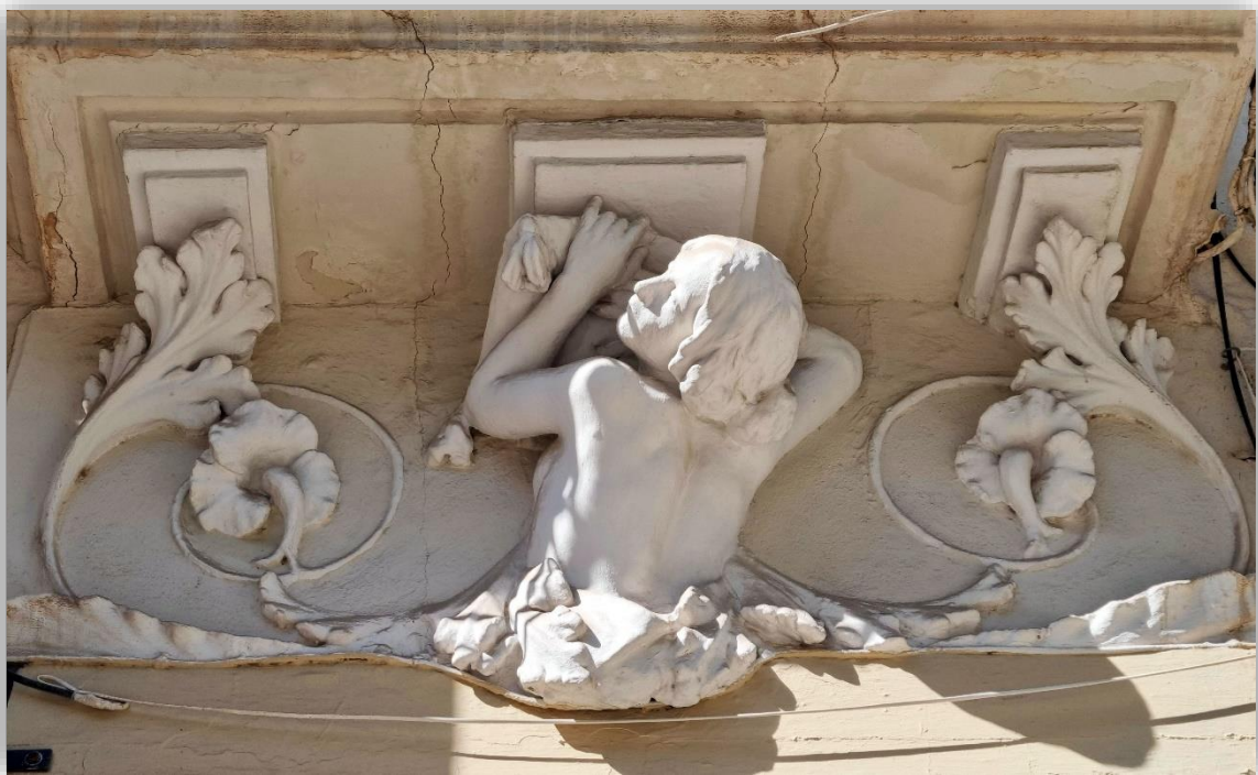
Fotografías 8.264 y 8.265: detalles ornamentales modernistas del edificio ecléctico de la Calle Eguilior, nº 3. Toman protagonismo la ornamentación de las barandillas del balcón central, los canecillos florales y las formas femeninas que sirven de aparentes apoyos a las bases de los balcones. Estos elementos decorativos fueron creados en yeso, por don Hilario Checa Sánchez. Capturas del 30 de julio (imagen superior) y del 1 de agosto (imagen inferior) de 2022.
