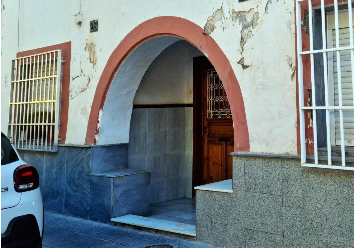
Fotografía 8.41: casa n° 26 de la Calle Baja de la Iglesia, en Regiones Devastadas. A pesar de sus modificaciones, su frontis aún conserva el arco y los poyos del portalón, para sentarse, que caracterizaban a la tipología edificatoria externa original de muchas viviendas del Barrio. Captura del 4 de diciembre de 2022.
